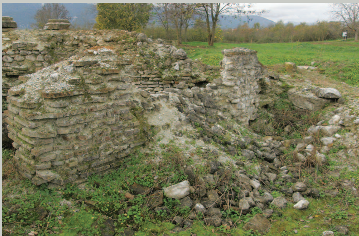
Εικ. 52. Κατάρρευση τμήματος της τοικοποιίας, το οποίο βρισκόταν σ' επαφή με τμήμα που είχε ανακτηθεί με τσιμεντοκονίαμα.
