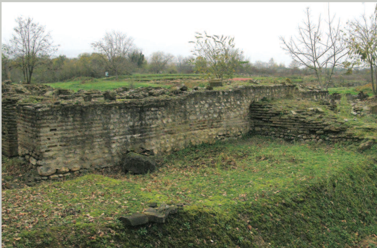
Εικ. 50. Η παλαιότερη επέμβαση αποκατάστασης με τσιμεντοκονίαμα στον ανατολικό περιμετρικό τοίχο.
