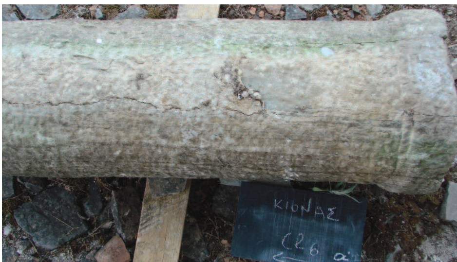
Εικ. 78. κίονας Cl 6: ρήγματα, λεπτές ρηγματώσεις και αποφλοιώση.
