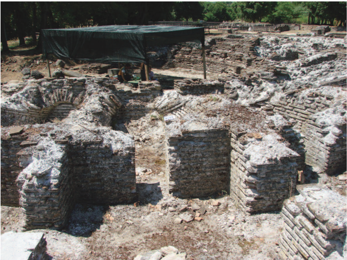
Εικ. 47. Η εικόνα των δωματίων της ανατολικής πλευράς. Διάβρωση του συνδετικού υλικού, αποκολλήσεις πλίνθων και καταρρεύσεις.
