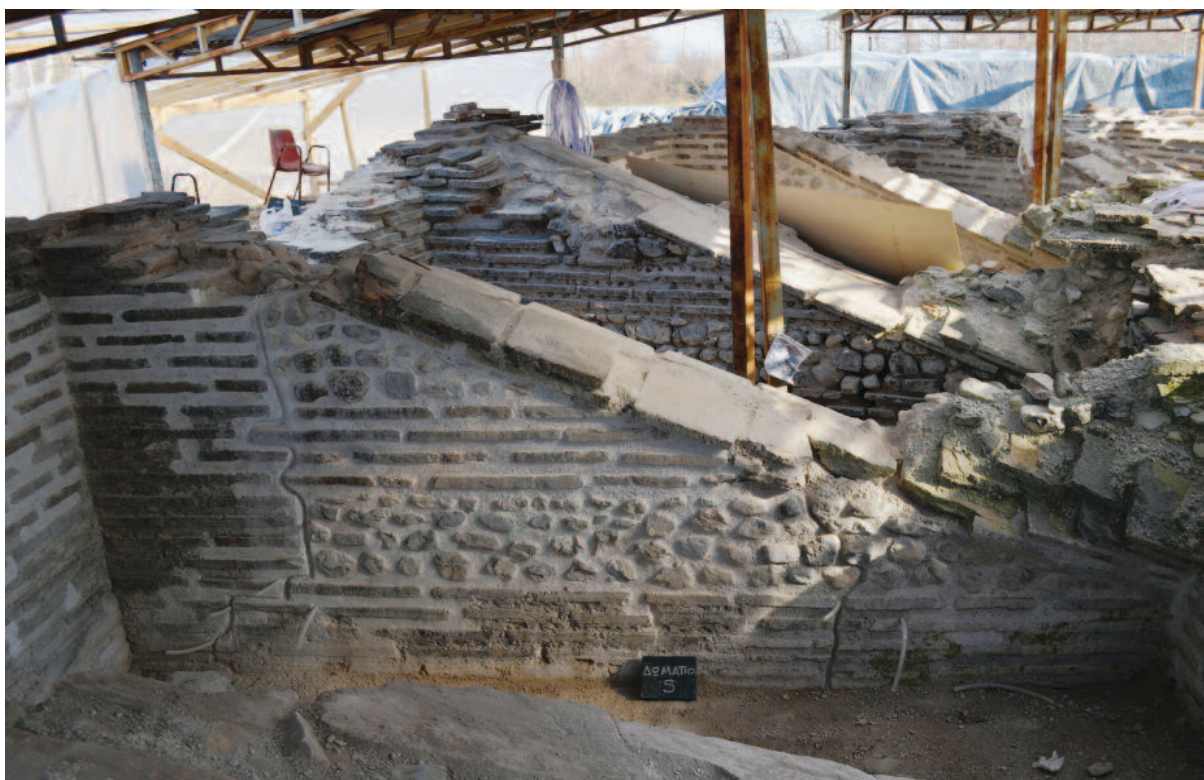
Εικ. 55. Οι ρωγμές σφραγίστηκαν σε επίπεδο χαμηλότερο της επιφάνειας, ώστε να διακρίνεται η παθολογία του μνημείου.
