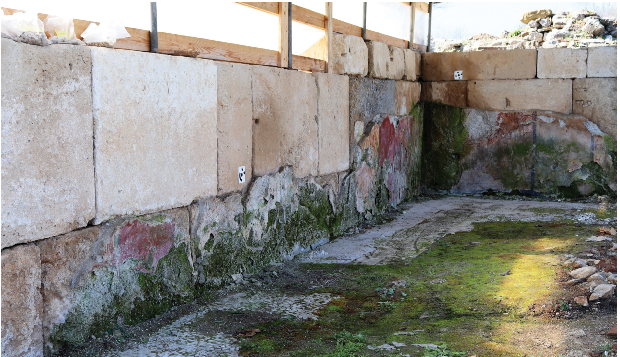
«Σεβαστείο». Το νότιο τμήμα της τοιχογραφίας, πριν τις εργασίες συντήρησης.
